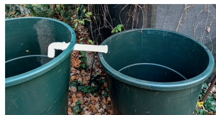
Kaskadowe połączenie zbiorników na wodę
