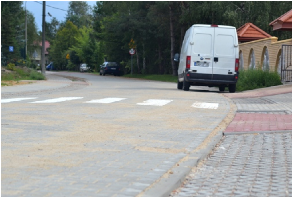
W tym roku zostały już zakończone dwa etapy prac na ul. Krokusa
